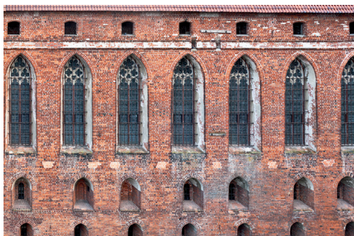
Fot. 18 i 19. Zamek Średni. Elewacja północna zachodniego skrzydła przed i po konserwacji
