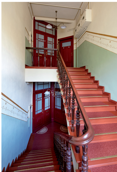
Najwyższa kondygnacja klatki schodowej w kamienicy przy ul. Warmińskiej 8; przed i po zakończeniu prac konserwatorskich
