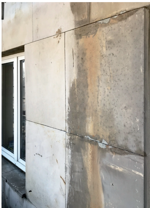
Fot. 2. Nawarstwienia zabrudzeń na powierzchni piaskowca
