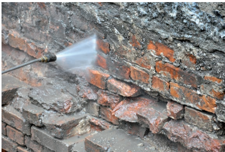
Ściana fundamentowa z cegły (fot. po lewej). Przygotowanie podłoża z wykorzystaniem myjki ciśnieniowej.
