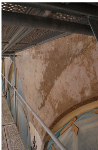
Wilgotne plamy na zasolonych tynkach pod balustradą maswerkową, stan po oczyszczeniu powierzchni wypraw.
