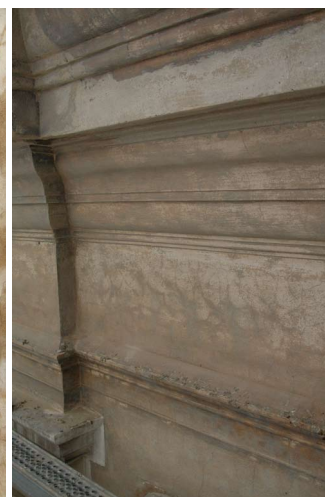
Przetarcia cienkiej warstewki cementu romańskiego, odsłaniające jasny podkład z tynków wapiennych.
