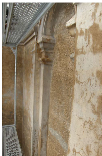
Wilgotne zaplamienia i siatka rys skurczowych na oryginalnych wyprawach dziewiętnastowiecznych, z tynkami fakturalnymi w blendach.
