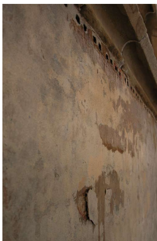
Oblodzenia i odspojenia powierzchni zawilgoconych tynków pod balustradą maswerkową.
