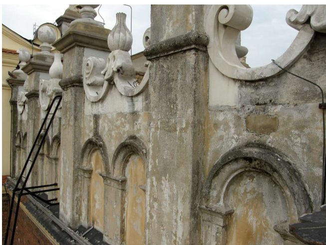
Zniszczenia i korozja biologiczna tynków attyki ryzalitu zachodniego przed konserwacją.
