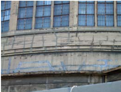
Fot. 3 – Stare naprawy pierścienia dolnego kopuły
