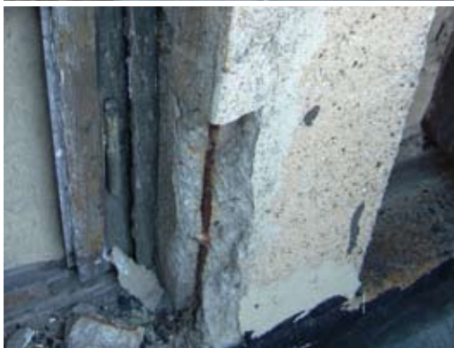
Fot. 4 – Uszkodzenia wcześniej wykonanych napraw
