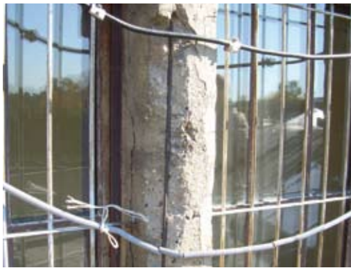
Fot. 2 – Typowe uszkodzenia elewacji
