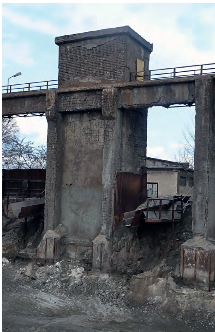
Degradacja betonu konstrukcji instalacji gaszenia żużla.
