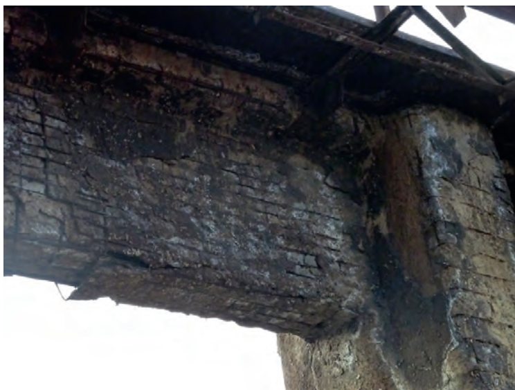
Zniszczenie betonu belek podsuwnicowych (strefa I).
