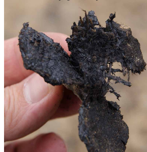
Pozostałości starej hydroizolacji.
