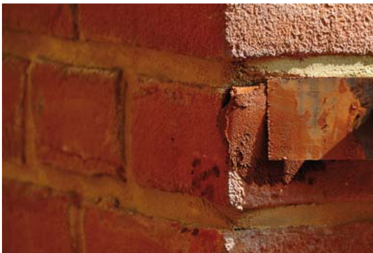
Cegły na niezabezpieczonej tynkiem elewacji szybko ulegają procesowi starzenia i destrukcji.
