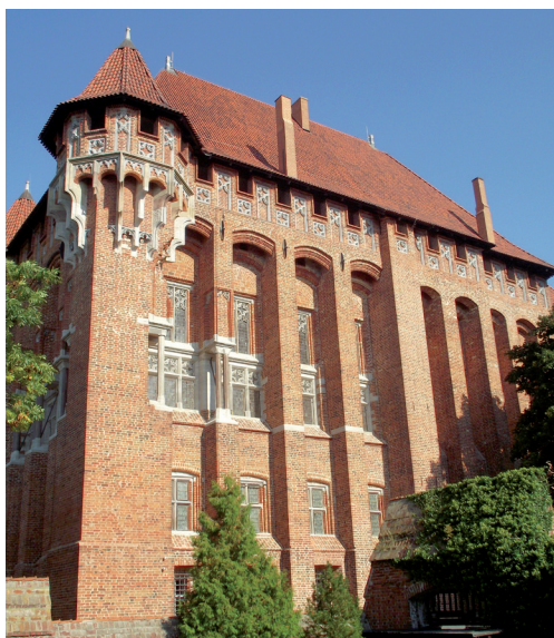
Pałac Wielkich Mistrzów – elewacja południowa po renowacji z użyciem zapraw wapienno-trassowych Optosan w 2010 r.
