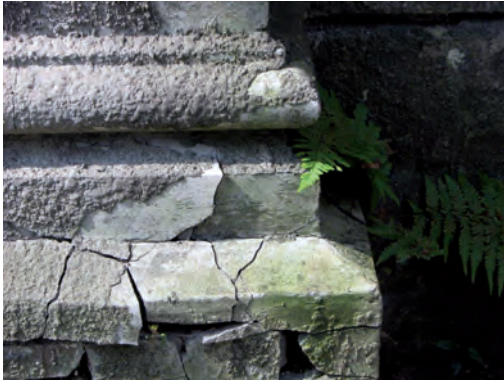
Narzut cementowy na gładkich powierzchniach.
